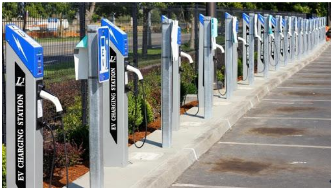
Εικόνα 15: Παράδειγμα σταθμών φόρτισης ηλεκτροκίνητων οχημάτων σε υπαίθριο χώρο.
